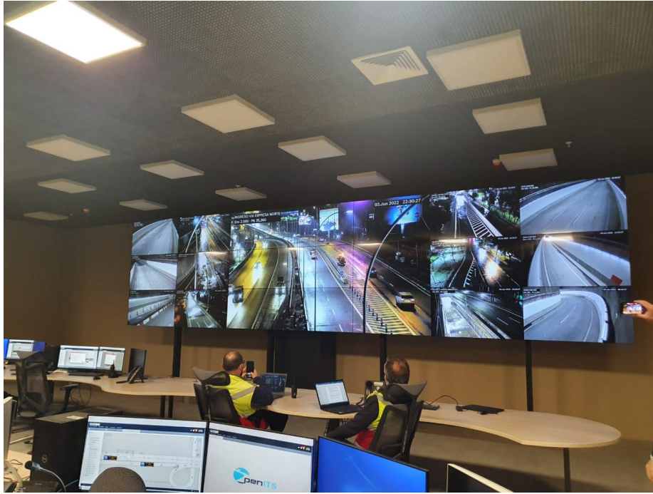
Centro de Control Túnel 9,5 Km urbano AVO (Americo Vespucio Oriente) (Chile)
